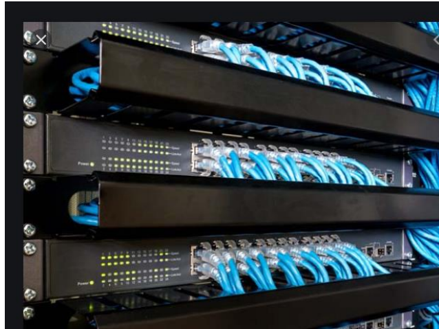
Figura 5 - Rack Cabeamento estruturado
