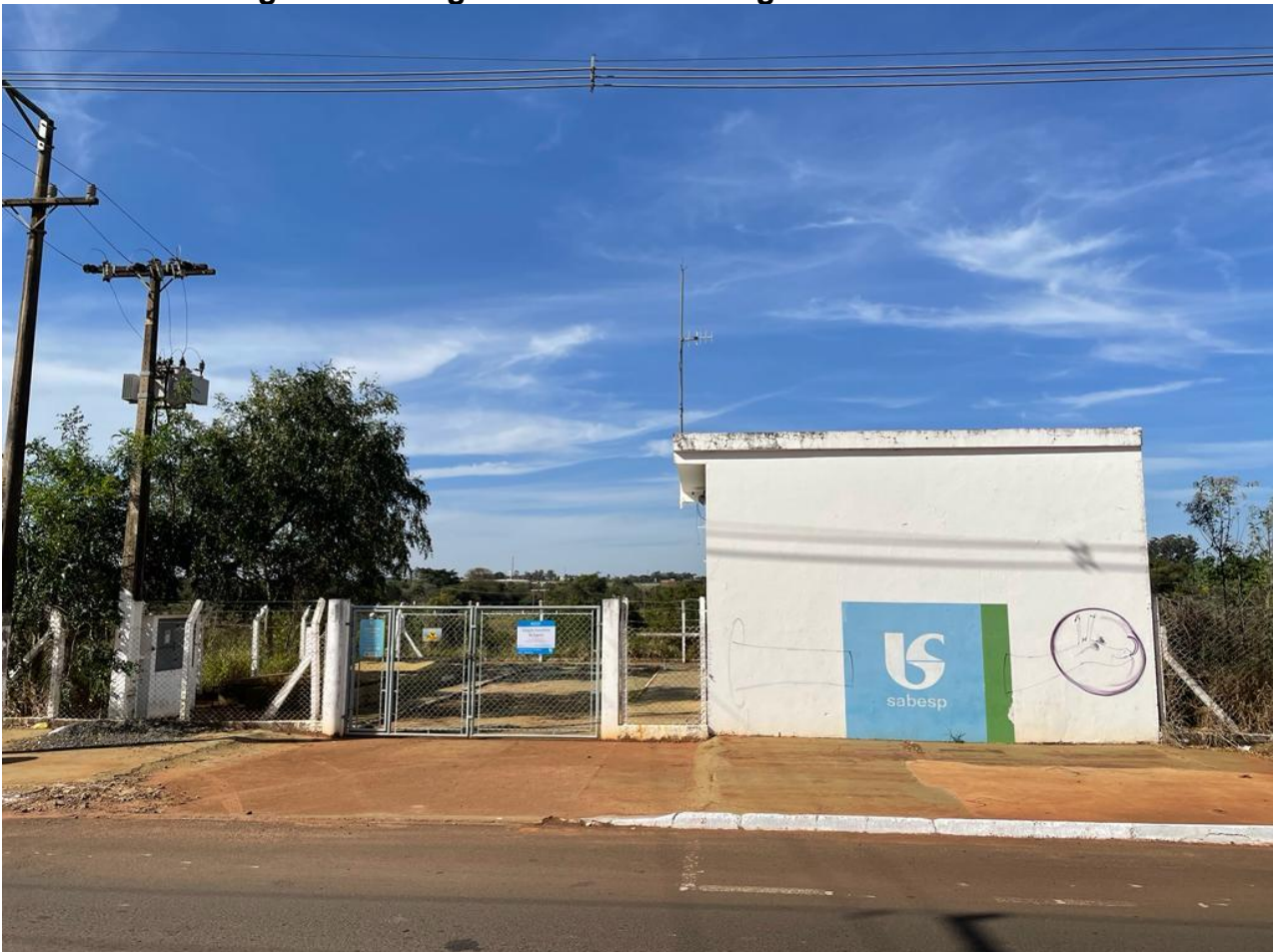
Figura 15: Imagem da EEE vila Progresso da SABESP
