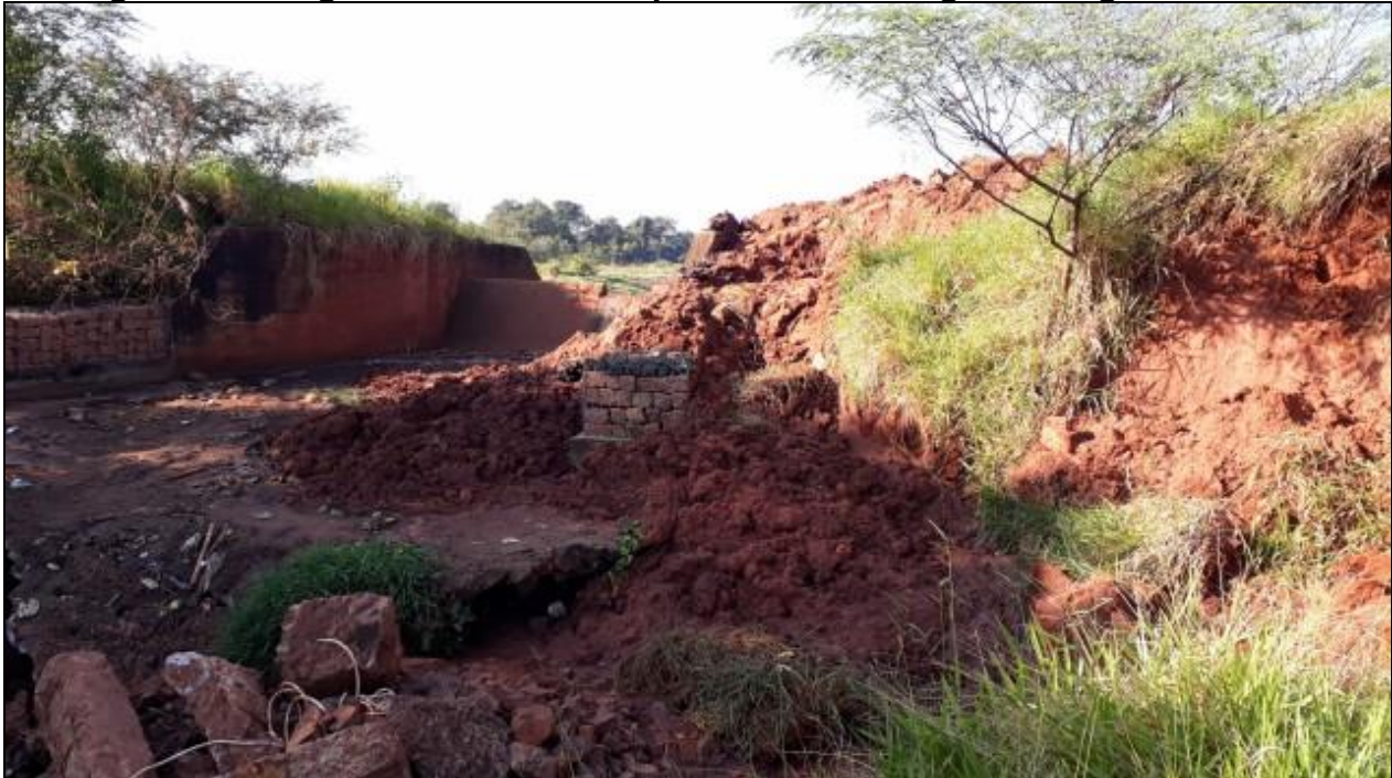
Figura 19: Imagem da área do rompimento da barragem da Água da Porca
