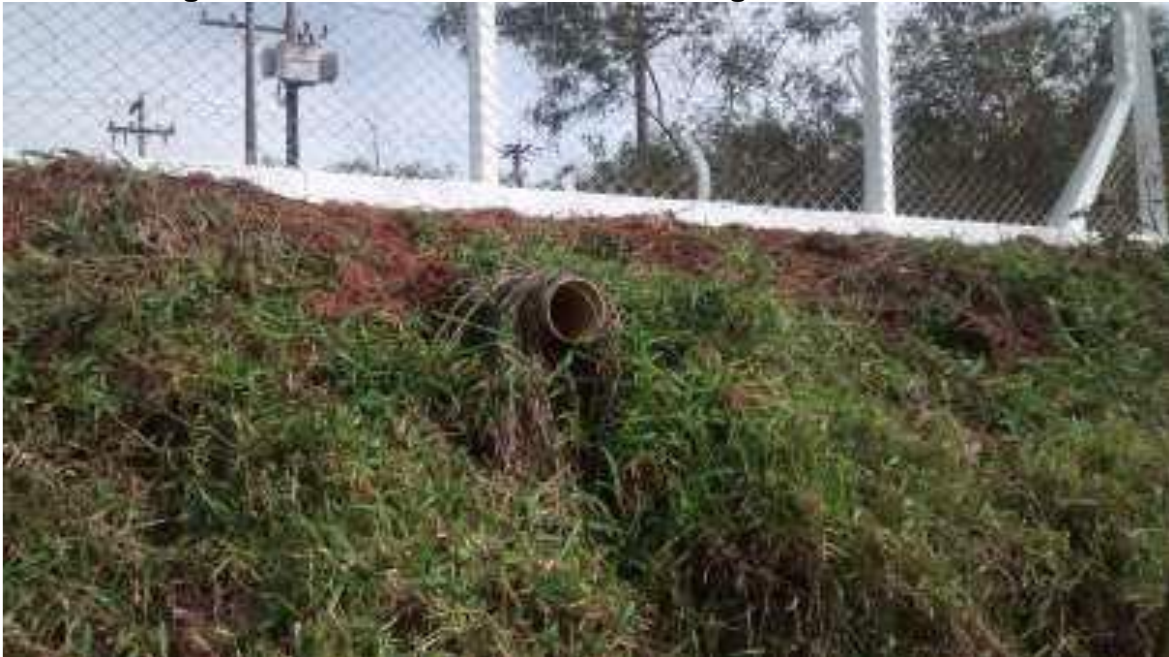
Figura 16: Extravasor da EEE Vila Progresso da SABESP
