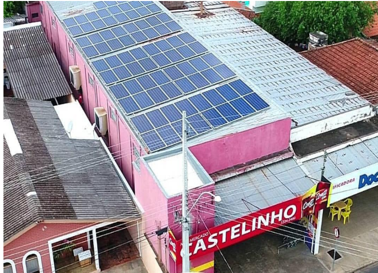
Figura 8: Placas Fotovoltaicas instaladas sobre o telhado da empresa (Fonte: Nexo Energia Solar)
