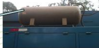
Cilindro de ar do compressor implemento comboio
