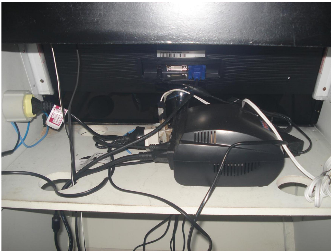
Figura 82 – Tomada interna do gabinete e estabilizador que distribui energia para todos os equipamentos
