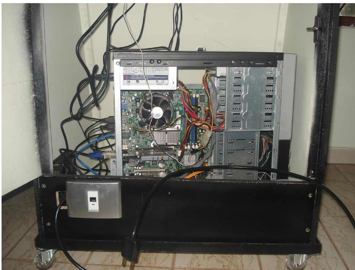
Figura 79 – Computador instalado na parte inferior do gabinete, visível o cabo que admite energia para dentro do gabinete e interface de comunicação ethernet
