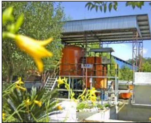
Figura 14: Tanques de estocagem de água tratada 14
