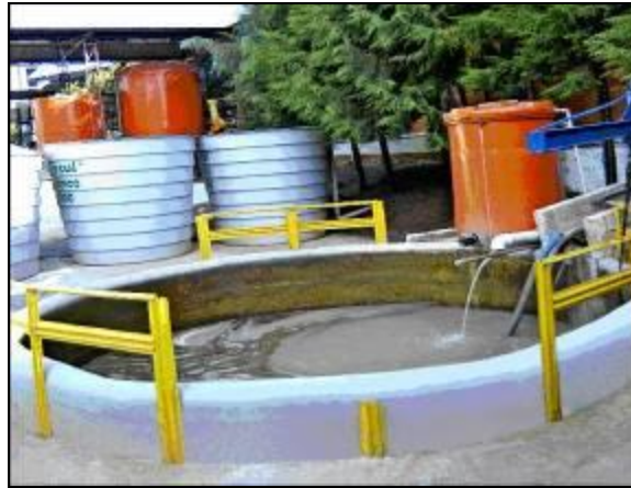
Figura 12: Tanque de decantação do lodo 14 .
